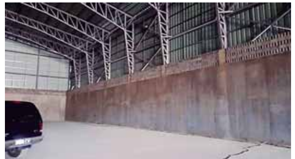
La bodega queda en la carretera a San Pedro Sula. Se almacenará yeso, hierro, clínker, "petcoke" y carbón mineral.
