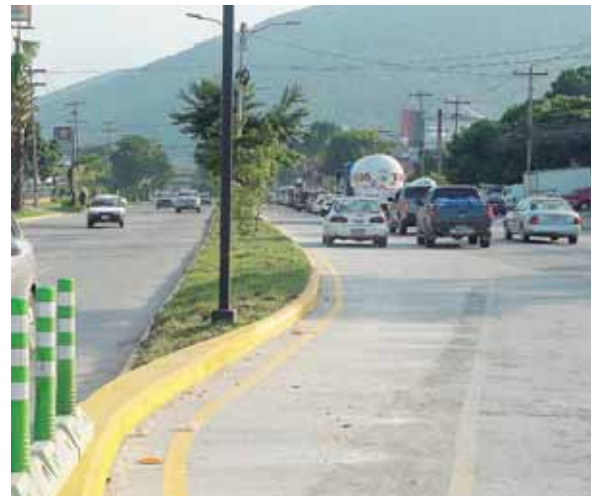
El carril de incorporación tiene una medida de 140 metros lineales, lo que permitirá a los conductores un acceso más seguro.
