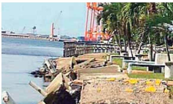
Tras varias décadas de sufrir tormentas y el embates del mar, el malecón del barrio La Laguna luce semidestruido.
