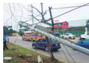
El poste de concreto quedó totalmente desprendido.
