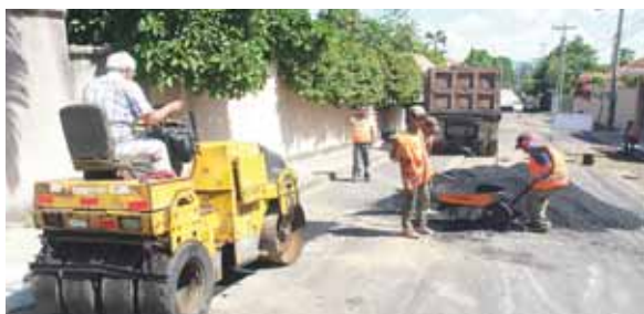
En la colonia Trejo y en los Alpes los equipos de mantenimiento realizaron las pavimentaciones.
