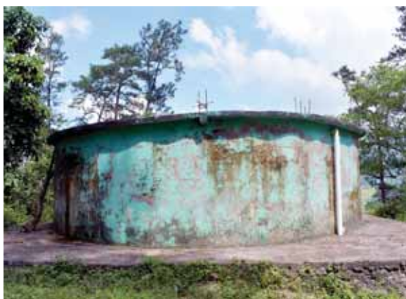
Los pobladores coinciden en que este tanque de agua tiene fuga en una de sus tuberías y por eso ha habido deslizamientos.
