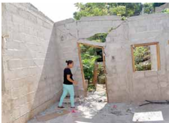
Esta casa de concreto se rajó parcialmente la tarde del pasado miércoles. Los afectados están viviendo donde otros familiares.
