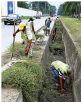
En cada ciclo limpian 95 mil metros lineales de canales
