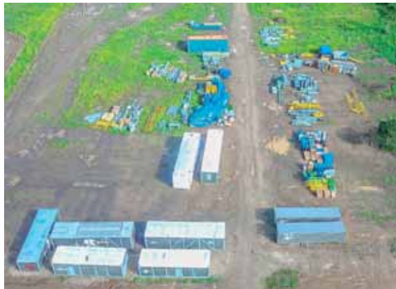
Vista panorámica de la maquinaria industrial en el plantel donde se construirá la molienda.
