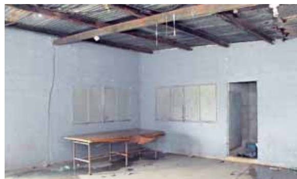
Los camerinos se inundan constantemente de aguas negras y su techo es una completa coladera.
