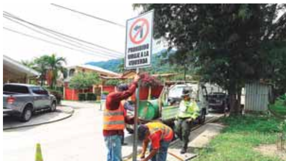
Con la señalización de las vías, los usuarios podrán desplazarse de forma más segura, con visualización clara, completa y adecuada.
