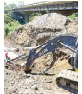
El colector drenará entre 12 y 15 metros cúbicos de agua lluvia por segundo.
