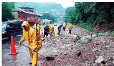
Derrumbes en la salida al sur dejaron escombros.
