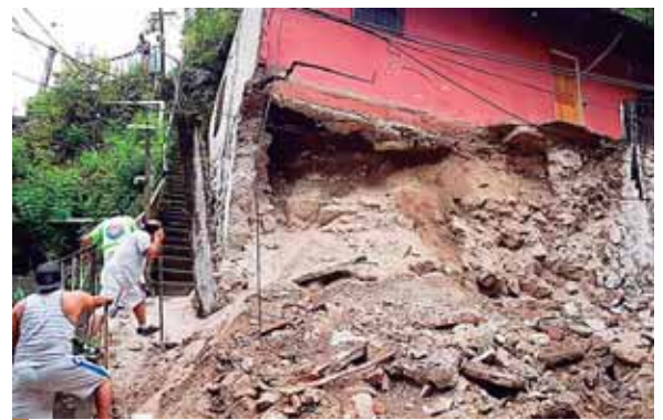
Esta casa está a punto de ceder luego de más de dos días de lluvias. La colonia Canaán se ha visto muy afectada.
