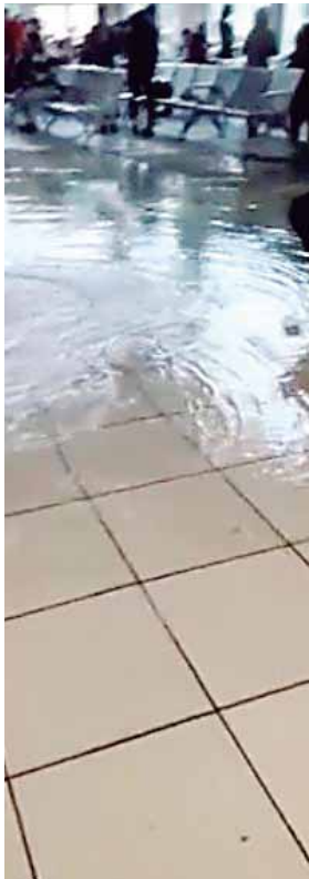
En el IHSS de San Pedro Sula, las aguas negras colapsaron.
