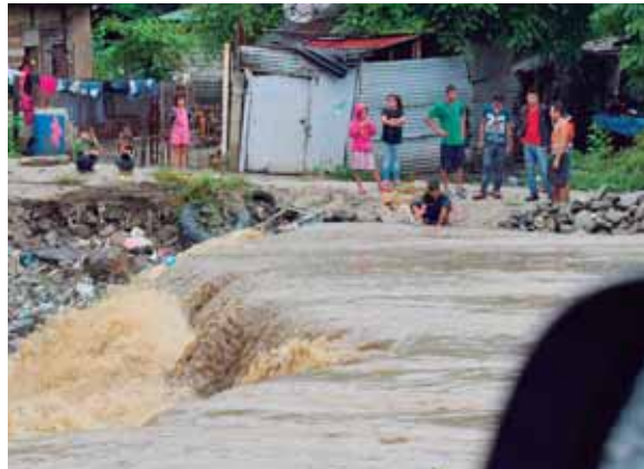
En la plancha del puente que conduce a Ticamaya, la quebrada aumentó su caudal, poniendo en alerta a los pobladores.
