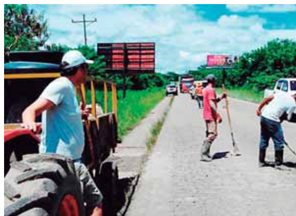
Los pobladores de Danlí ya no tendrán que andar tapando baches.
