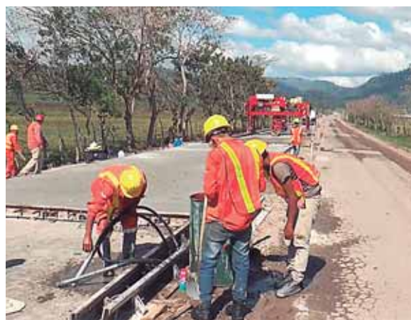
Los trabajos son con concreto hidráulico. Utilizan alta tecnología para garantizar una obra de calidad, dicen sus constructores.
