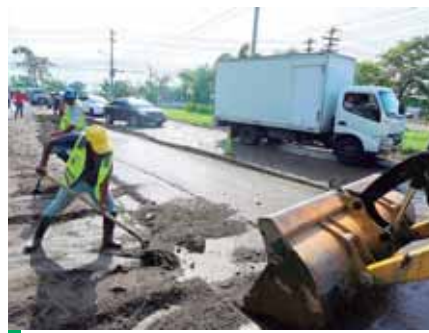
El sedimento que quedó en las carreteras fue removido con ayuda de maquinaria.
