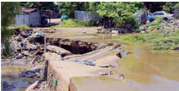
En el sector de Ticamaya las lluvias produjeron derrumbes que obstaculizaron el paso. Los habitantes de la zona se las ingenian para cruzar.
