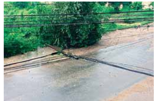
En el barrio La Victoria, de Villanueva, un poste del tendido eléctrico cayó luego de torrenciales lluvias.
