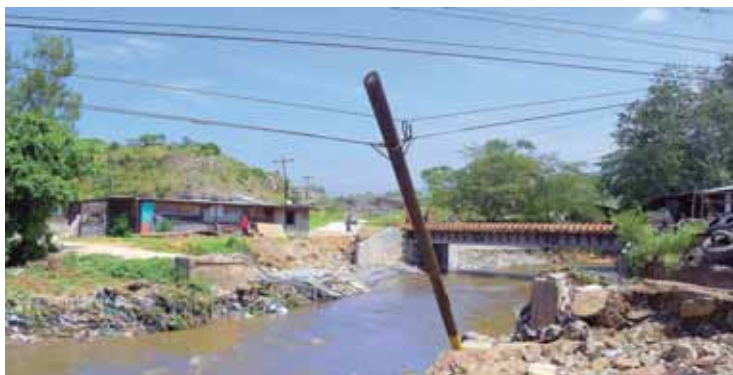
Este poste que detiene el tendido eléctrico fue dañado por los fuertes vientos y aún permanece inclinado ocasionando un peligro para los que transitan por Ticamaya.
