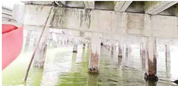
Un equipo de ingenieros porteños evaluaron los daños al puente y consideraron que se deben tomar medidas para evitar su colapso.
