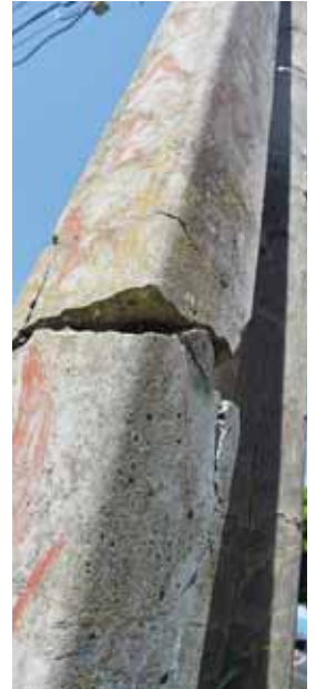
La columna está quebrada en sus cuatro costados.
