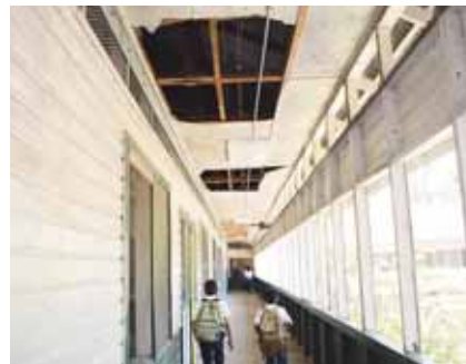
El techo del Centro Básico Esteban Guardiola se ha ido cayendo poco a poco.
