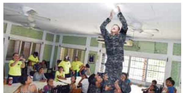
No todo fue diversión, los militares también se interesaron en arreglar algunos desperfectos del edificio.
