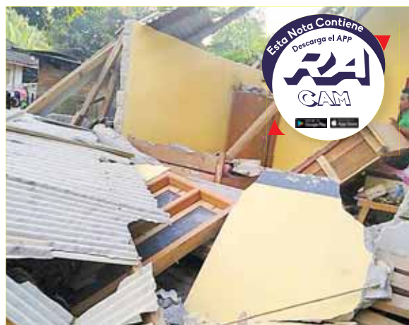
Tras el sismo principal se registraron al menos veinte réplicas que dañaron miles de edificaciones.
