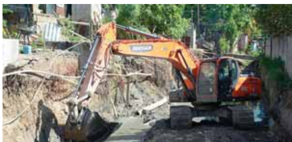
Con equipo pesado trabajan en la construcción de los colectores de aguas lluvias.
